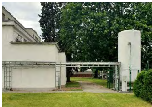
Рис. 27. З'єднання кріобанку з резервуаром для зберігання рідкого азоту за допомогою ізольованого трубопроводу.
