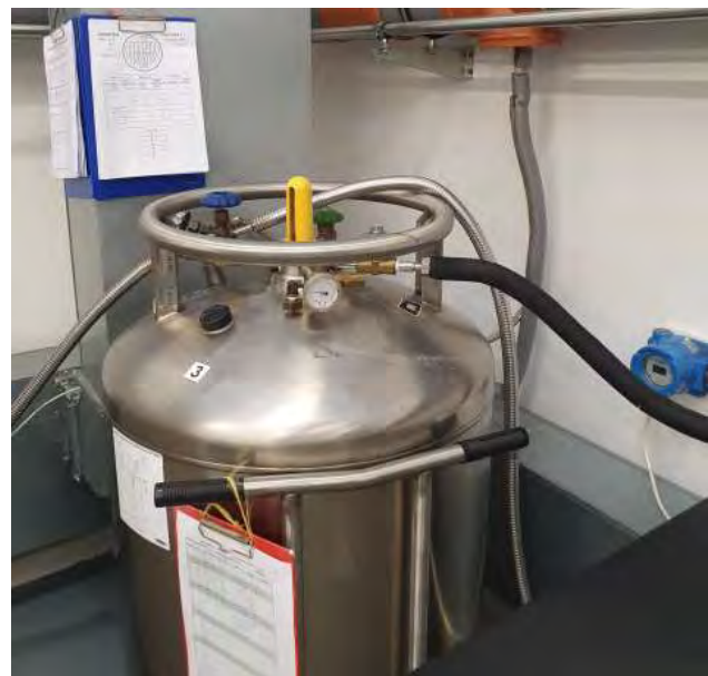
Рис. 32. Резервуари «Eurocyl 230 LP» (Chart-Ferox, Чеська Республіка), розміщені всередині кріобанку та з'єднані з трубопроводом рідкого азоту за допомогою ізолюваного шлангу.
